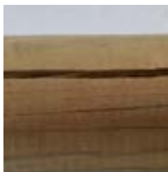
Cracks/Grietas/Fente/Risse/ Crepe/ Barsten/Fendas
